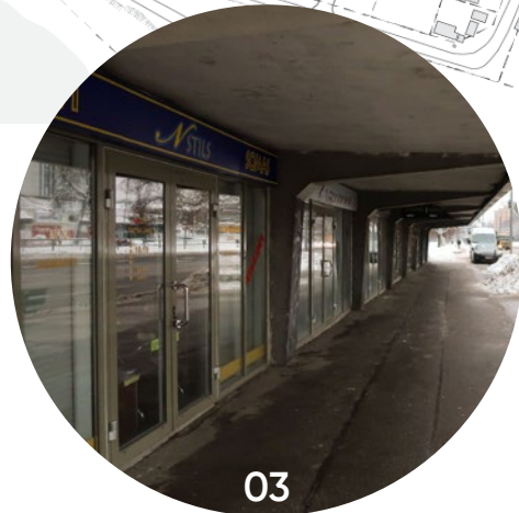
Ēka veido pārkari pār gājēju zonu, trūkst apgaismojuma
