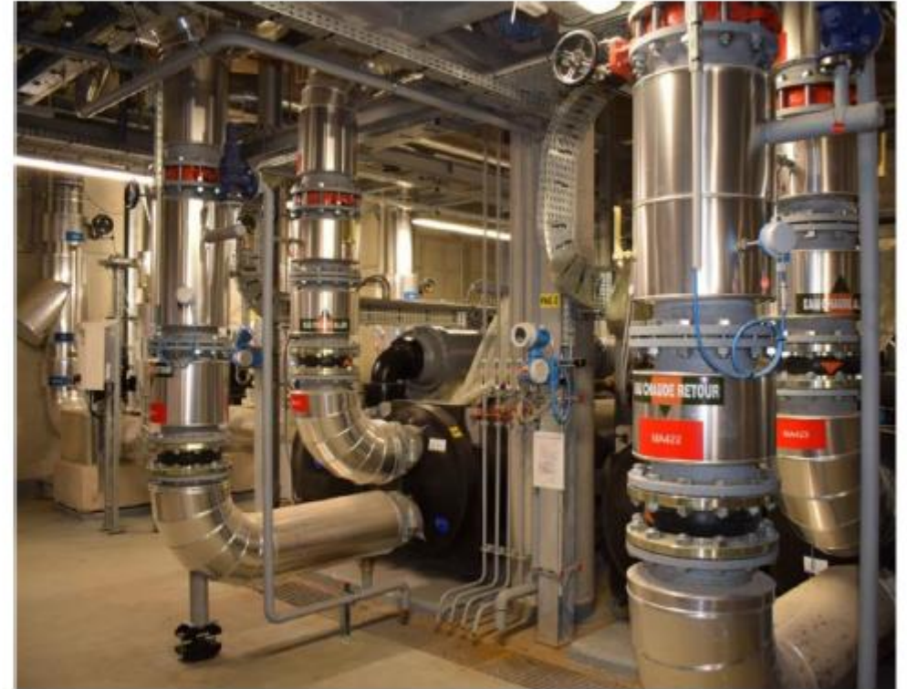
Station de géothermie dans l'éco-quartier Clichy-Batignolles (17e)
