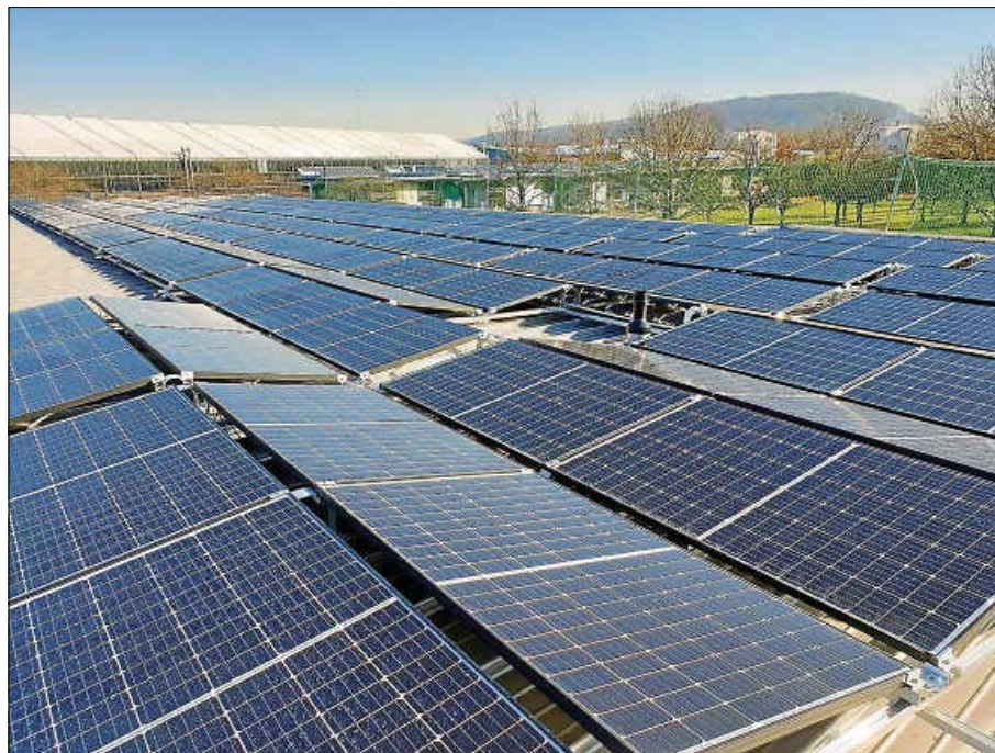
Neu hinzugekommen ist die PV-Anlage auf der LKW-Garage der Stadtwerke Ettlingen GmbH.
