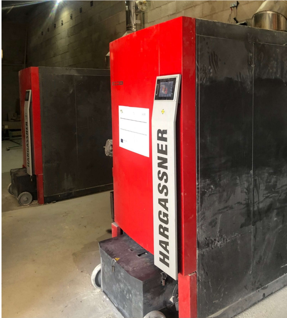
Sala de calderas
