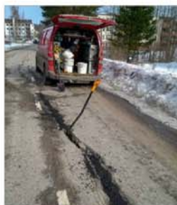
Muikkujankadun routarepeämiä on jo jouduttu täyttämään.
